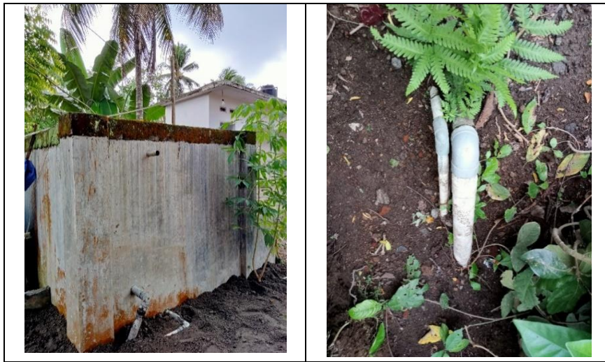
Gambar 3. Sistem Distribusi Air Kokok Tojang, Bak Penampung Pertama (Kiri), dan Pipa Distribusi (Kanan)
