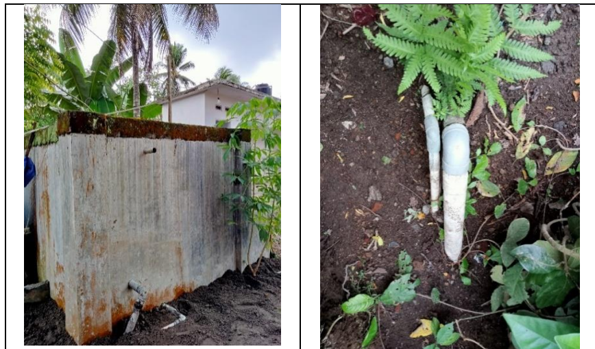
Gambar 3. Sistem Distribusi Air Kokok Tojang, Bak Penampung Pertama (Kiri), dan Pipa Distribusi (Kanan)
