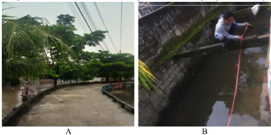
Gambar 3. A) Kondisi Terjadi Banjir; B) Kondisi Drainase Eksisting
