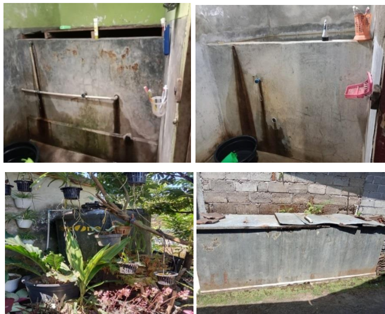
Gambar 5 Bak Penampung Air & Tandon Air Penduduk
