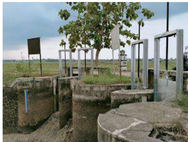
Gambar 13. Bangunan Sadap KBh 5 Tahun 2020
