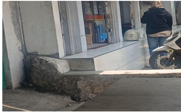
Gambar 1. Pembatas air di depan toko (Sumber: Dokumentasi Penelitian, 2026)
