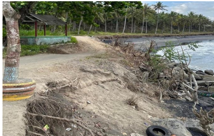
Gambar 5. Kerusakan Infrastruktur Jalan di Pantai Maiq Anyir (Sumber: Dokumen Peneliti, 2025)
