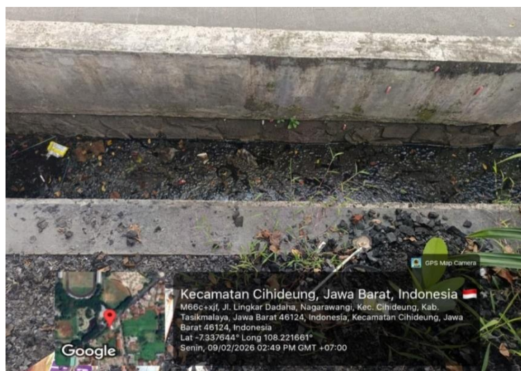
Gambar 5. Kondisi Saluran Air di Sekitar SPA Sampah Dadaha (Sumber: Dokumen peneliti, 2026)
