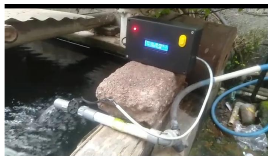
Gambar 12. Alat yang sudah terpasang pada pipa PDAM pelanggan.
